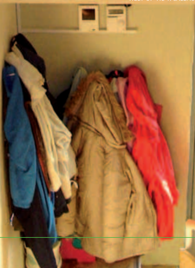
UNDERSIDEN AF DEN NYE HEMS. FØR VAR DER HUL HELT OP TIL 1. SALENS LOFT.
